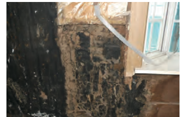
結露によりカビが生えた断熱材
