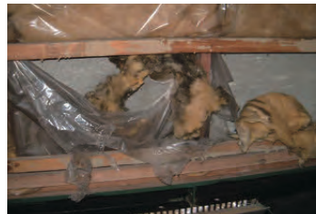
結露により劣化した断熱材
