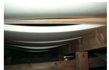
変形したボード系断熱材
