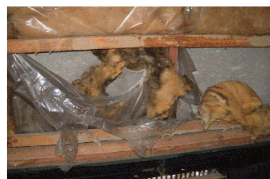
結露により劣化した断熱材
