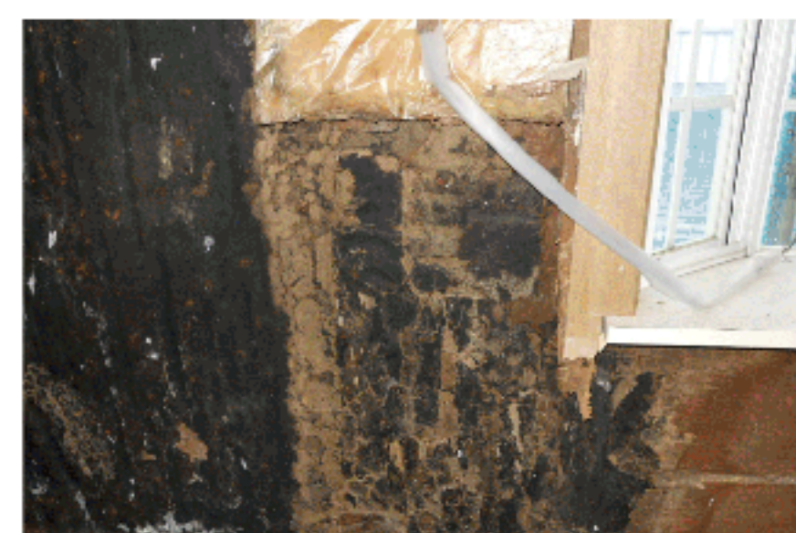
結露によりカビが生えた断熱材
