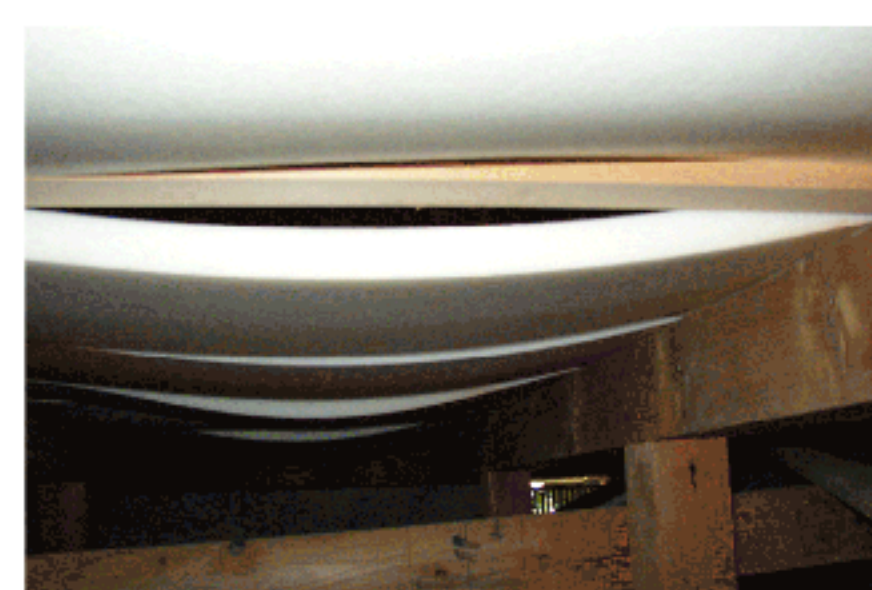
変形したボード系断熱材
